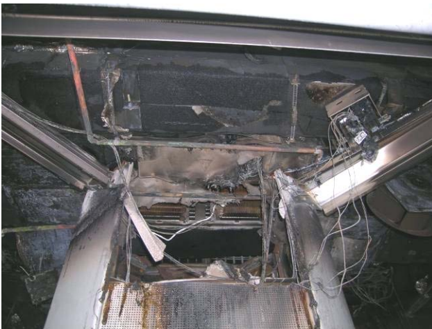
Figur 1 Brannskader i toppen av bagasjesøylen og taket i vestibyle 2 i BM 71003.
