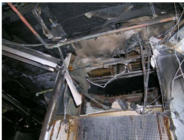
Figur 6: Bagasjesøylen sett fra siden mot inngangsdøren. Polykarbonatplaten som dekket øvre del av sideveggen har smeltet og brent opp.
